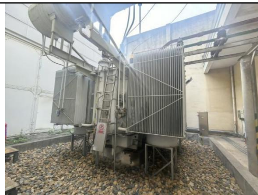
2#主变及贮油坑
