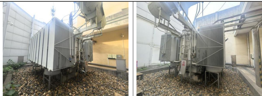
1#主变及贮油坑
